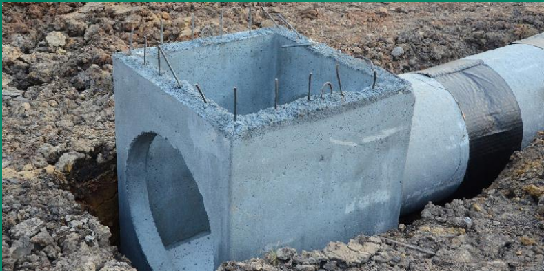
غرف التفتيش الخرسانية لأنظمة المياه أو الصرف الصحي
